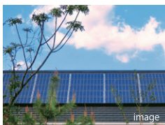
太陽光パネル
